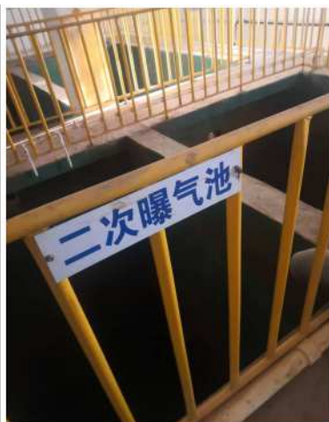
污水处理站二次曝气池
