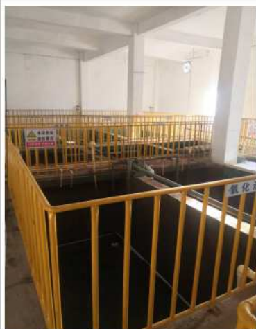
污水处理站氧化池
