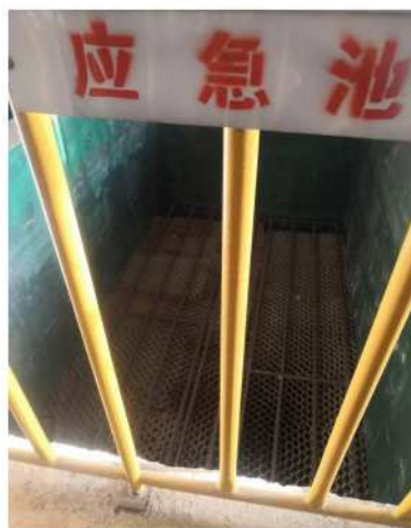
污水处理站应急池
