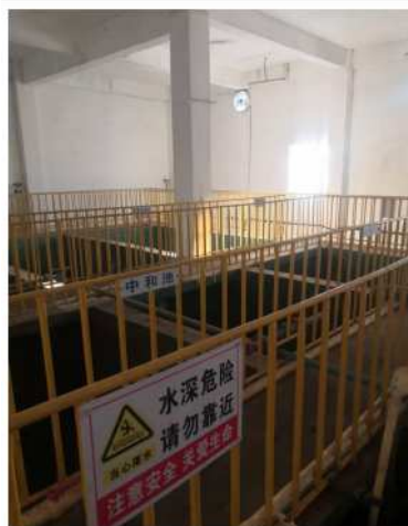
污水处理站中和池
