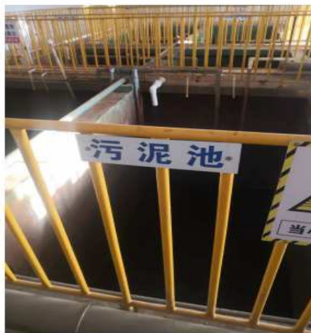
污水处理站污泥池
